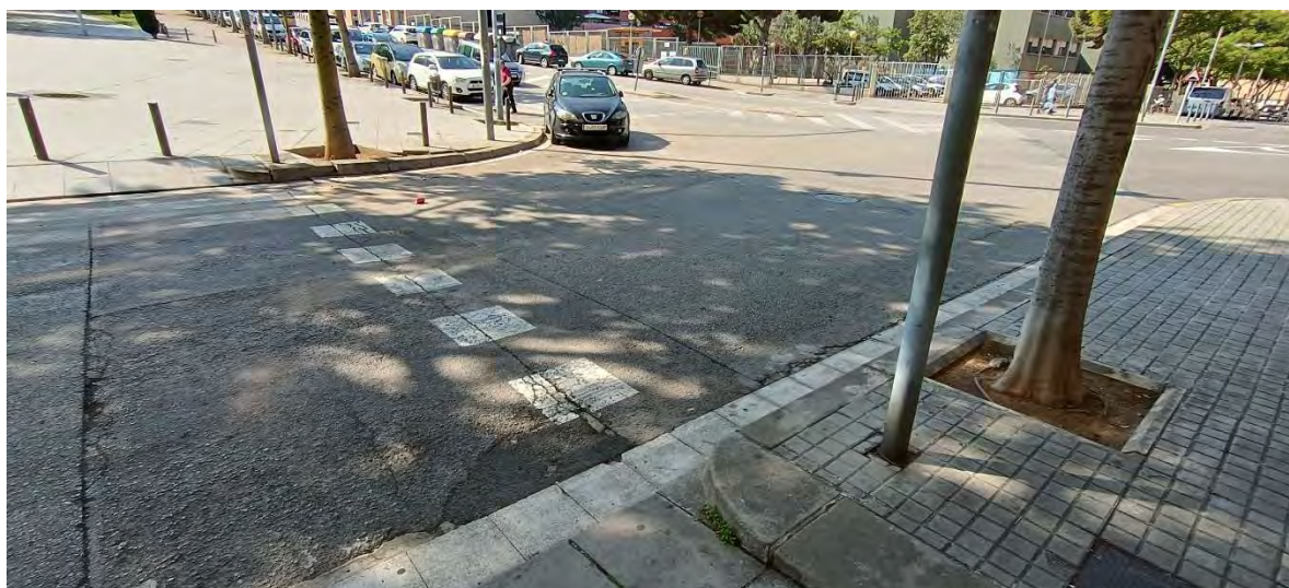
Estat del ferm en trobada amb C\ Rossini inclosa en àmbit d'actuació
