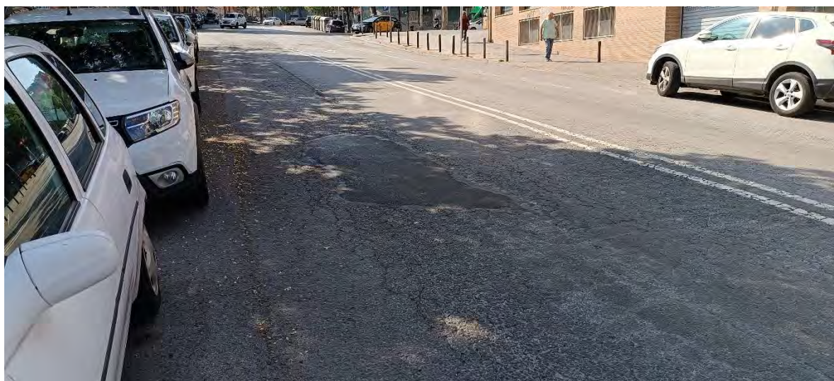
Estat de la calçada a l'alçada de la pujada-baixada prèvia a creuament amb C\ Liszt
