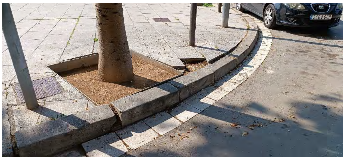
Tram de vorada i paviment a reparar en gir – creuament amb carrer Rossini.
