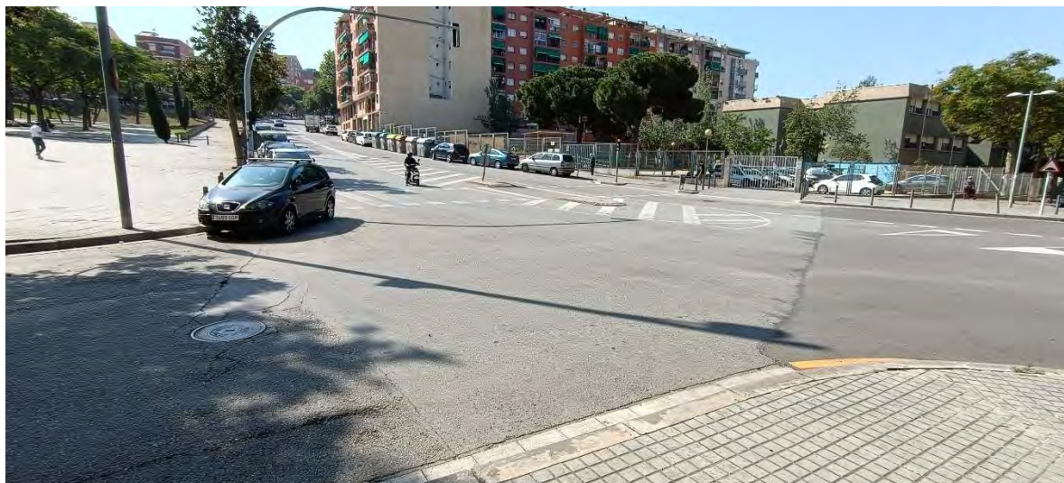
Estat del ferm a l'inici del Tram vist des d'incorporació de carrer Rossini
